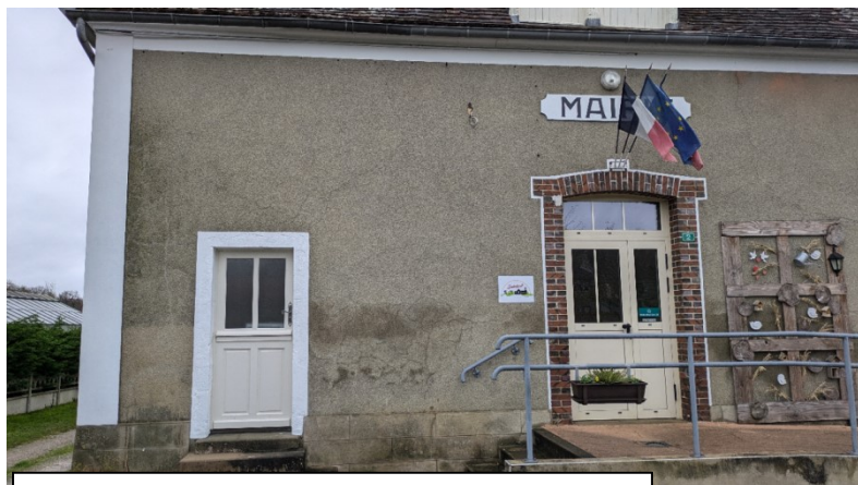
Bandes blanches sur le bâtiment mairie.
